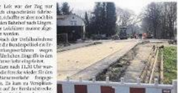
Am Bahnübergang am Heister Tunnel in Meppen findet jetzt die Aufräumarbeiten statt. Hier tauchte die am Dienstag der Zug eine Rüttelmaschine. Foto: Oliver Gombert/epic
