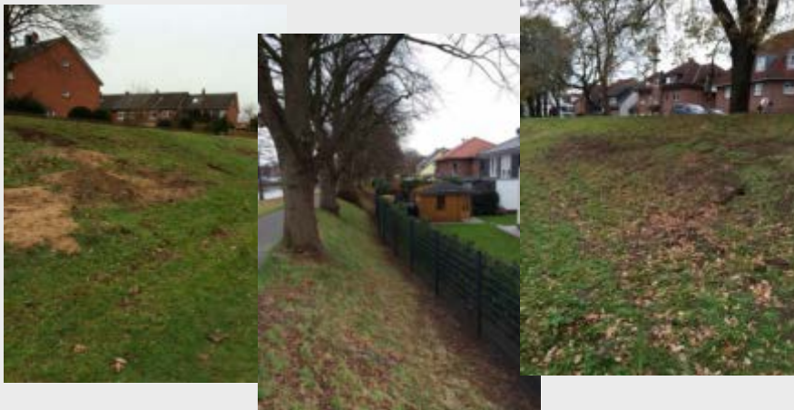
Regelmäßige Deichsichten und Unterhaltung der HW-Anlagen
